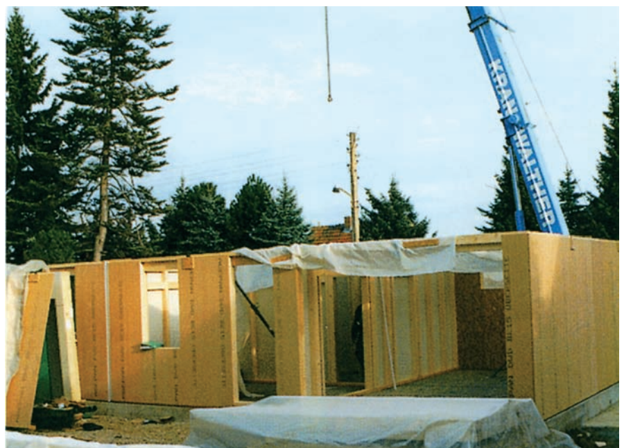
11 Tragende Außenwandkonstruktion, einseitig beplankt mit bituminierten Holzfaserplatten, ohne chemischen Holzschutz der Tragkonstruktion
