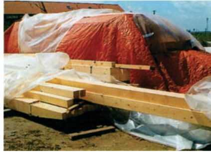
7 Unzureichend geschützte Lagerung der Holzkonstruktion auf der Baustelle - vor Einbau
